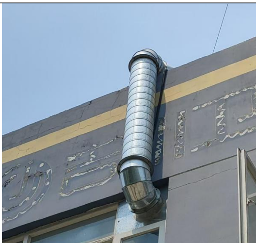
食堂油烟废气排放筒 P2 排放口规范化标识
