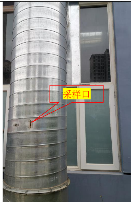
厂房三印刷废气排放筒 P1 采样口
