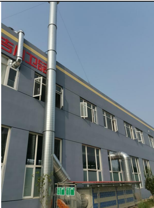
厂房三印刷废气排放筒 P1 排放口规范化标识
