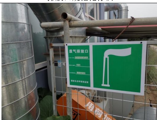
排放筒 P1 排放口规范化标识
